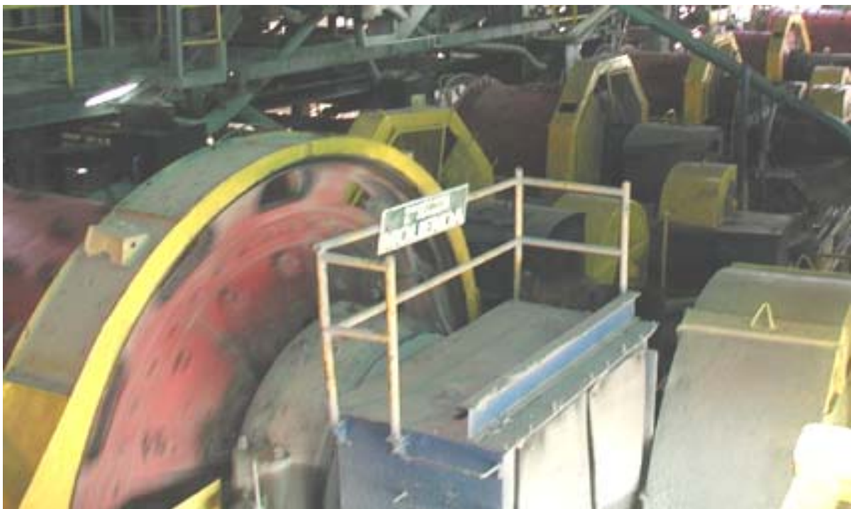
Fotografía N° 15: Dos módulos de molienda terciaria, conformada cada uno de ellos por tres molinos de bolas terciarios Allis Chalmers (7.5' x 7').
