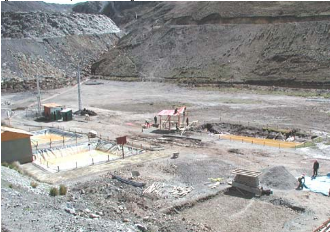
Fotografía N° 07: Planta de Bombeo de drenajes ácidos en el lado Norte del botadero Rumiallana, en la microcuenca del Río Tingo, nótese en las paredes del fondo cortes por donde se han instalado canales de coronación.
