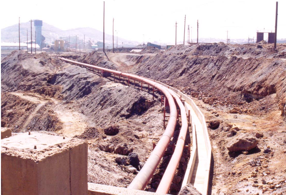
Fotografía N° 10: Tuberías de 14" de diámetro, que conducen los lodos provenientes de la planta de beneficio a la presa de relaves de Ocroyoc, actúan alternativamente la una como contingente de la otra, ambas con un canal de concreto de contingencia de ambas.
