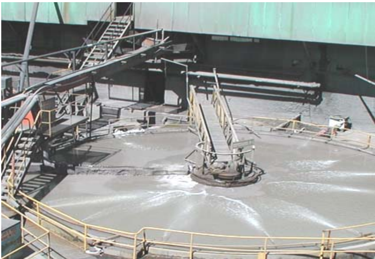
Fotografía N° 19: La eliminación de agua en el concentrado de Zinc se realiza en los espesadores, con la ampliación de la planta concentradora solo se repotenciara los espesadores para darle mayor eficiencia.
