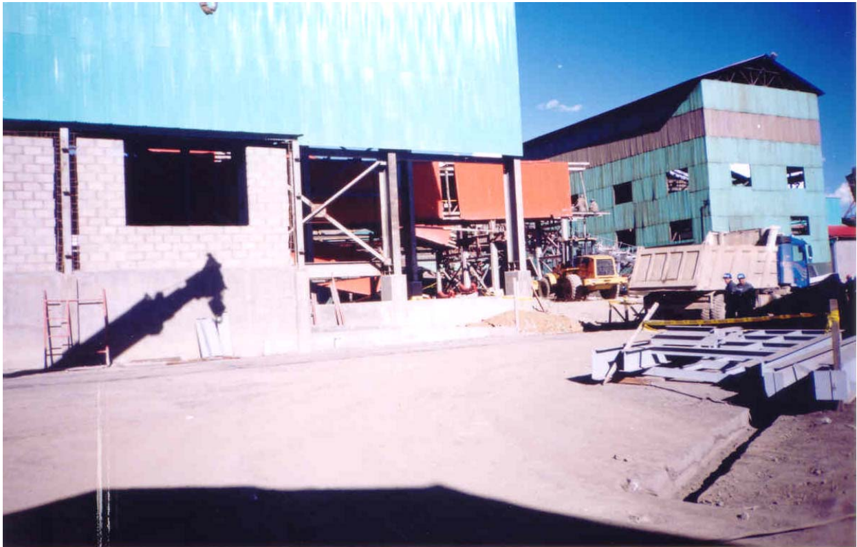
Fotografía. N° 12: Planta Concentración Paragsha en donde se ejecutará el Proyecto de Ampliación – Cerro de Pasco.
