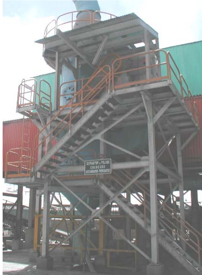
Fotografía N° 14: Extractor de polvo, ubicado en la sección Chancado permitiendo de esta manera reducir las emisiones de material particulado.
